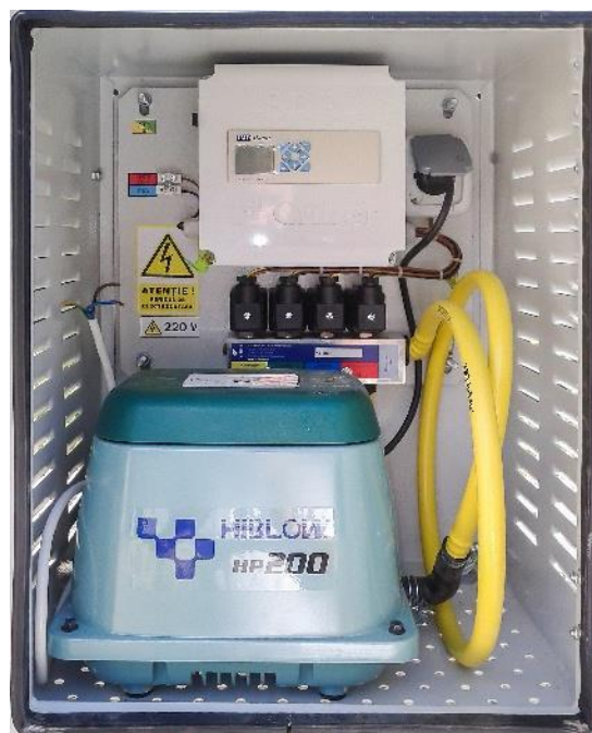
Fig. 3 Interiorul panoului de comandă
